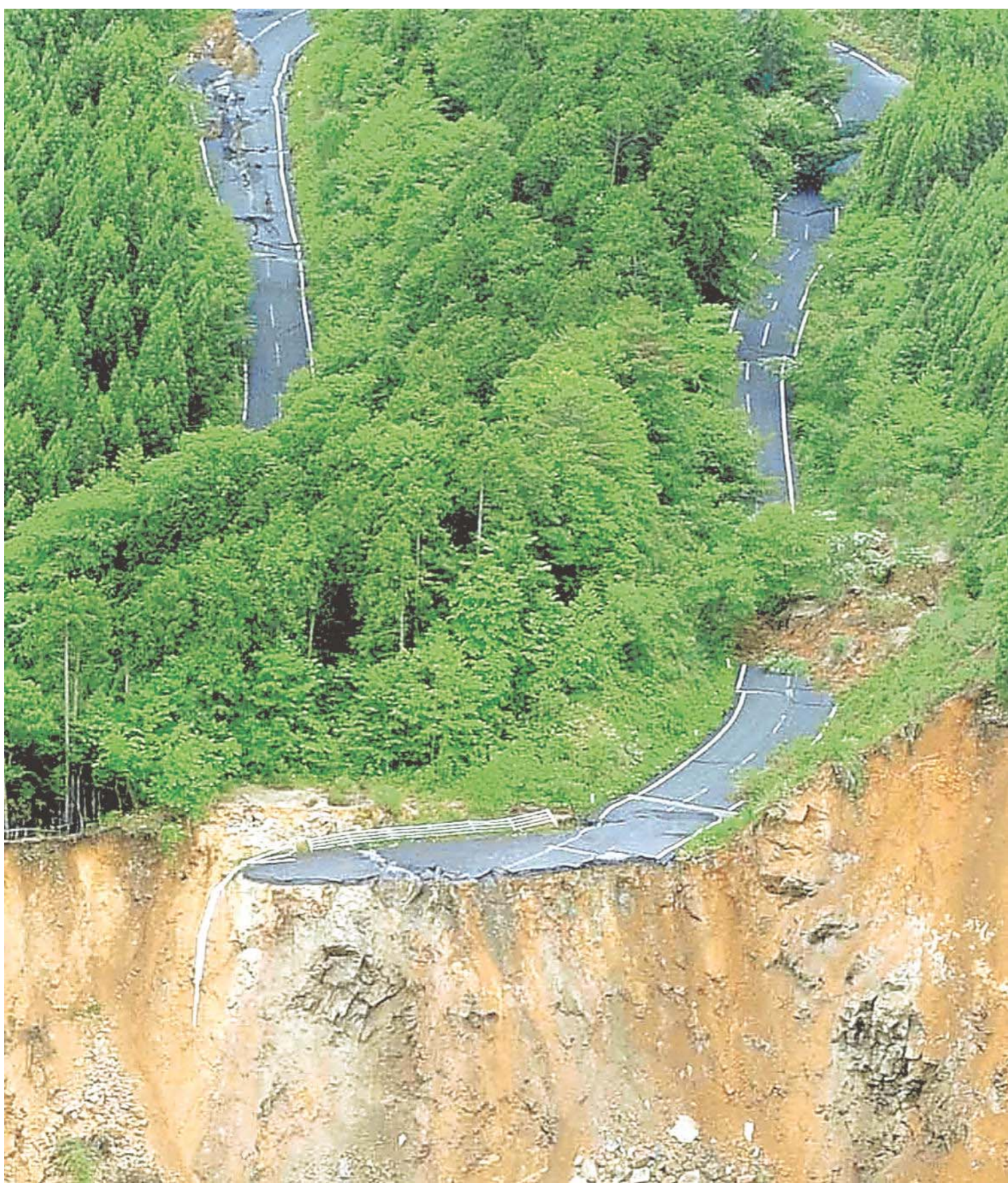
地震により陥没、崩落した道路。14日午前11時52分、宮城県栗原市で共同通信社へリから
